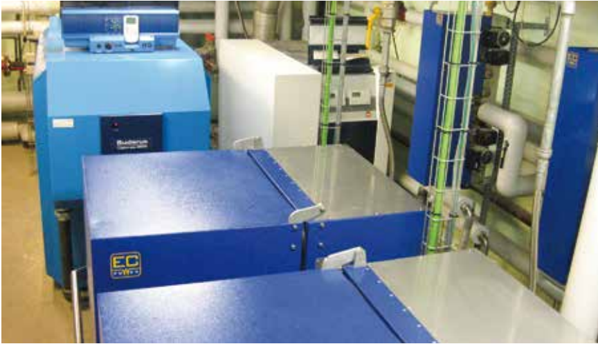
Figur 2: To stk. mini-KV-enheder (forrest) opstillet i kedelcentral; spidslastkedel ses bagerst.
